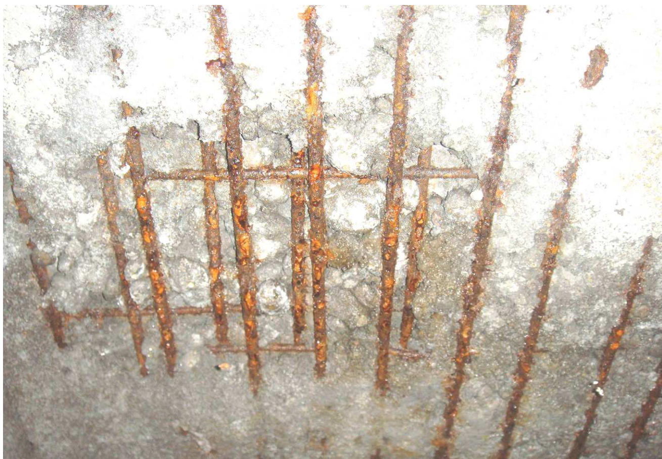
Рис. 18. Влажностные повреждения плит перекрытия подвала
