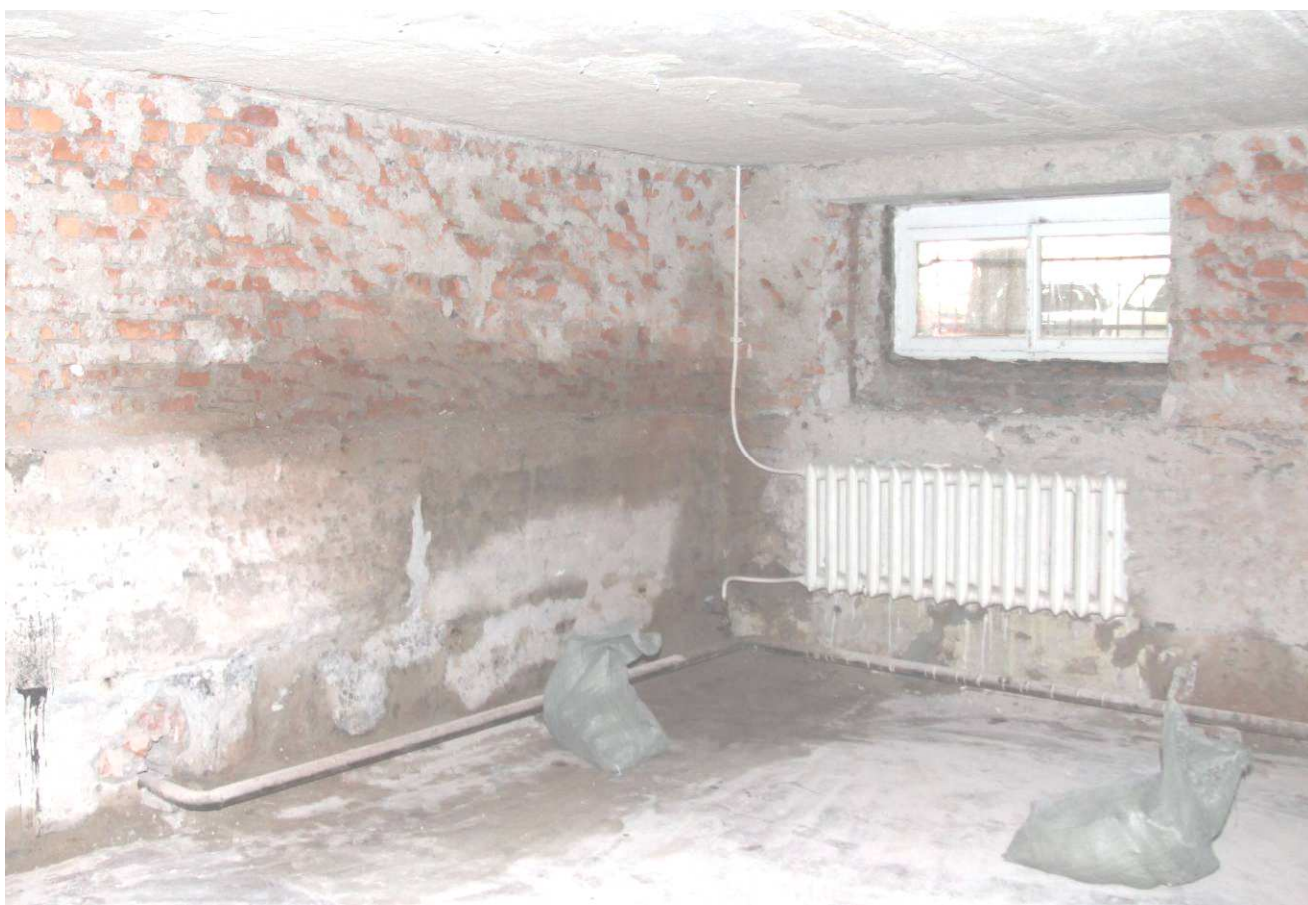
Рис. 9. Замачивание стены и фундаментов по оси И м.о. 10-11
