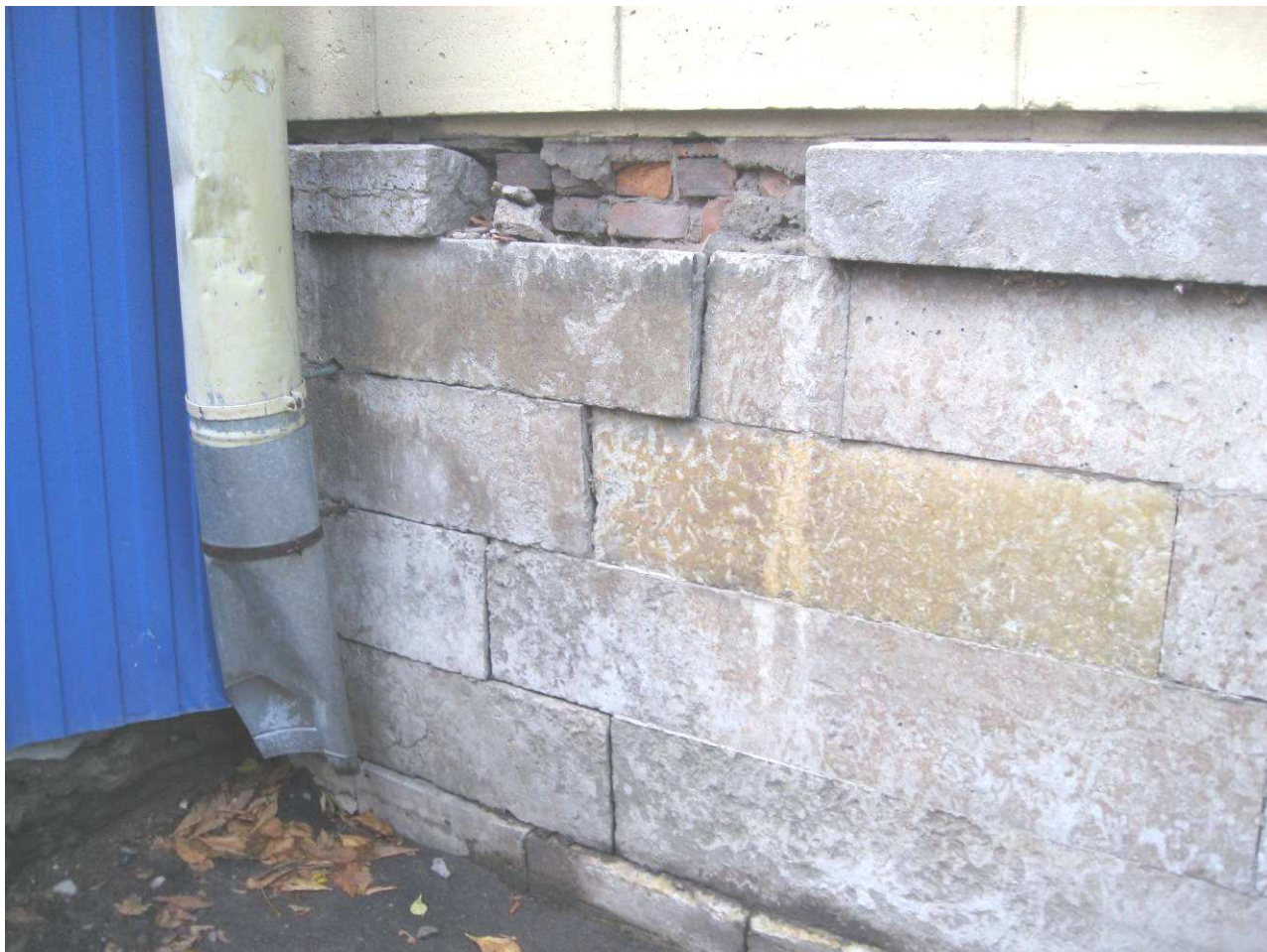
Рис. 10. Повреждение цоколя стены в осях 6-10
