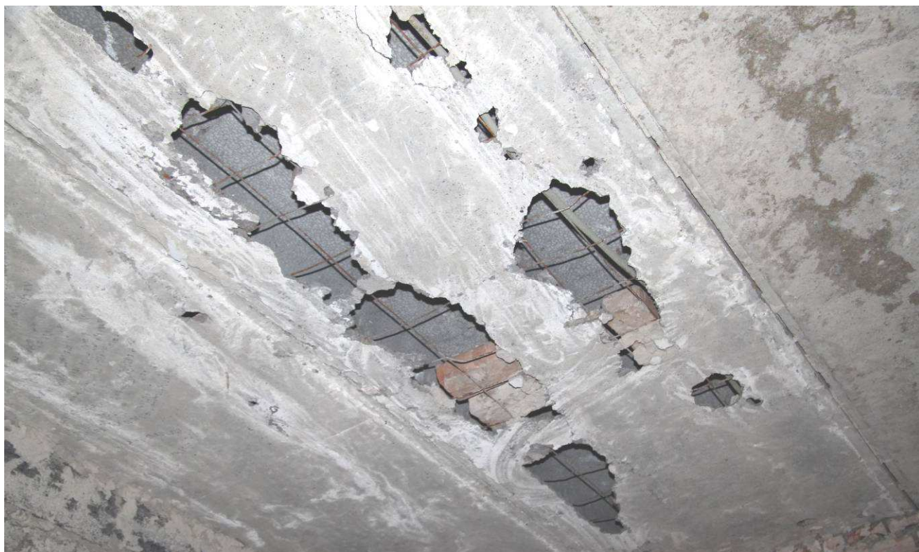
Рис. 17. Распространенный дефект плит перекрытия
