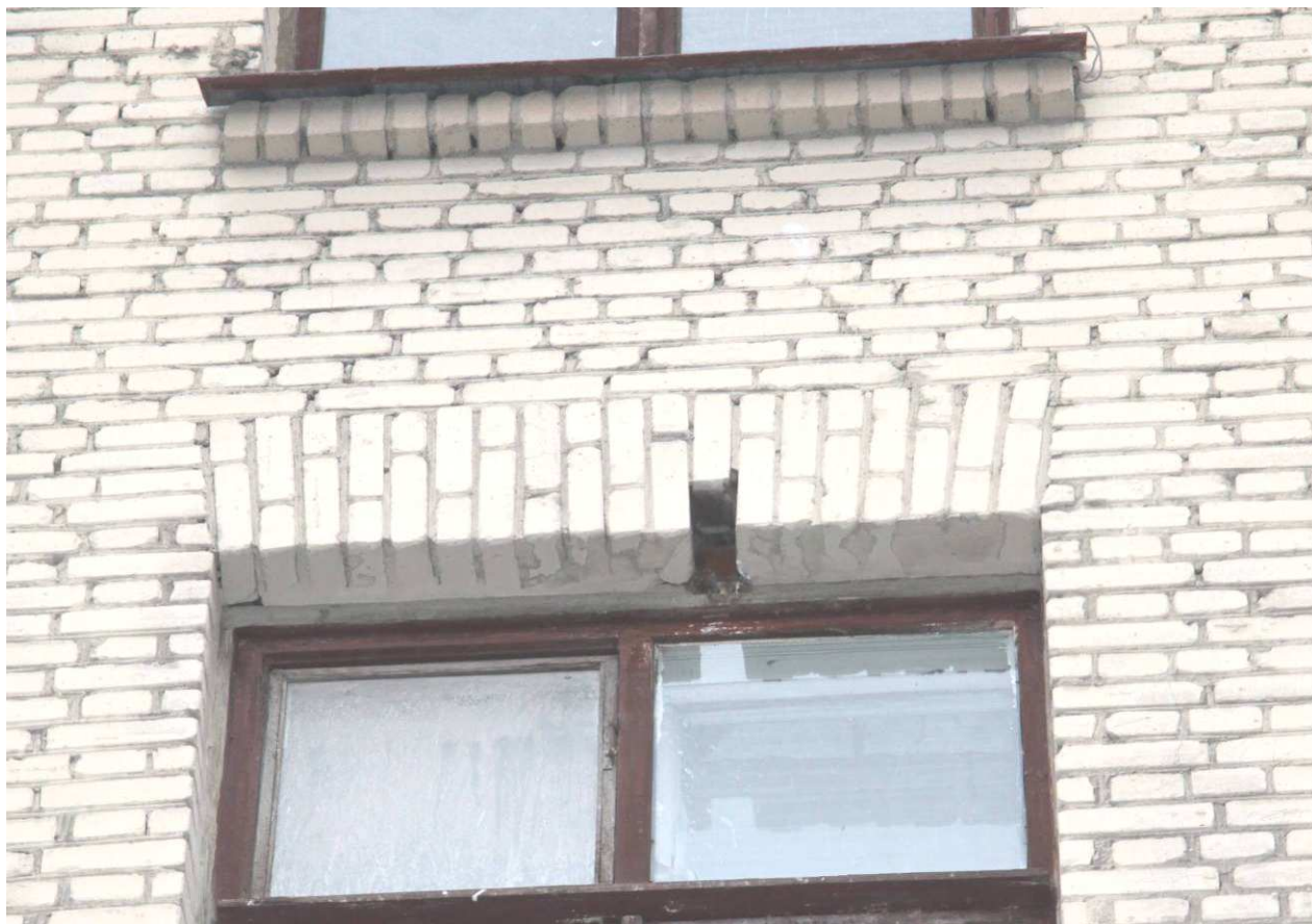
Рис. 11. Повреждение плоской клинчатой перемычки
