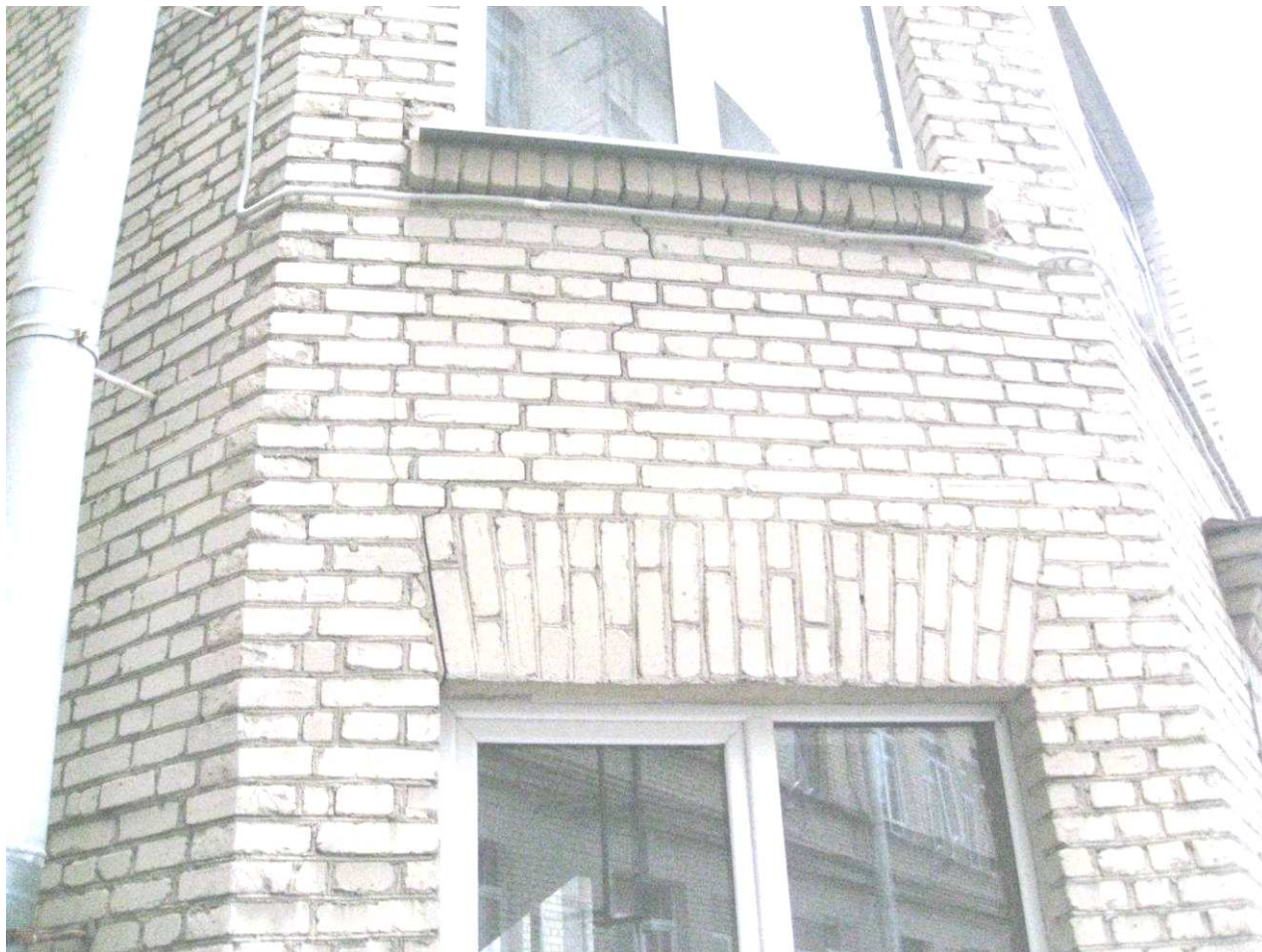
Рис. 12. Трещина фасада по оси Е
