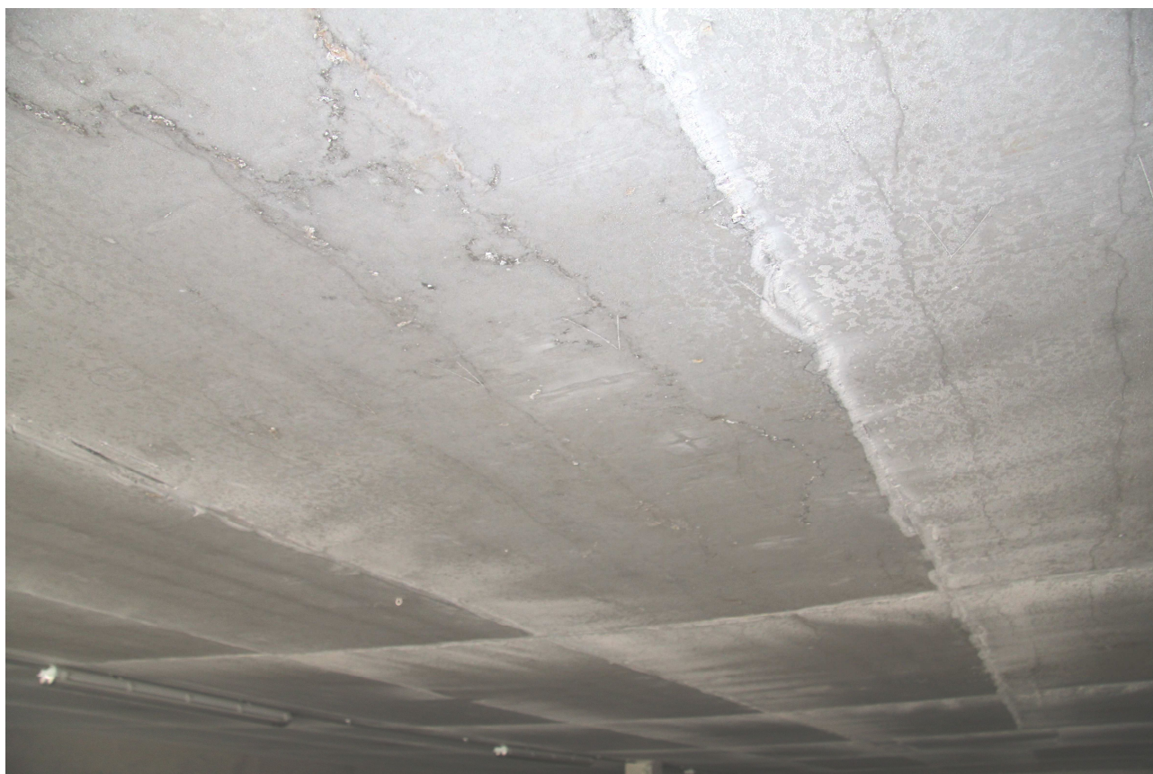
Рис. 3.4. Трещины на нижней поверхности плиты
