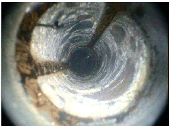
Металлическая конструкция в теле фундамента на глубине 0,6 м (фотография миниатюрной камерой внутри пробуренной скважины)
