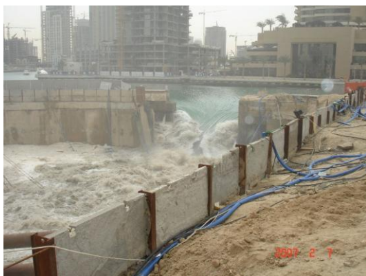
Авария котлована Инфинити Тауэр, Дубай (2007)
