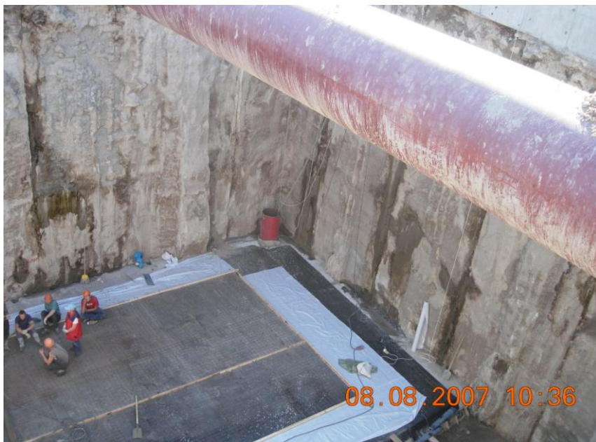
Первый в Петербурге удачный опыт устройства котлована под защитой стены в грунте на строительстве участков Орловского тоннеля.
