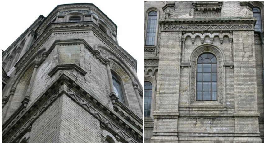
Дефекты, обусловленные проникновением атмосферной влаги и промораживанием кладки
