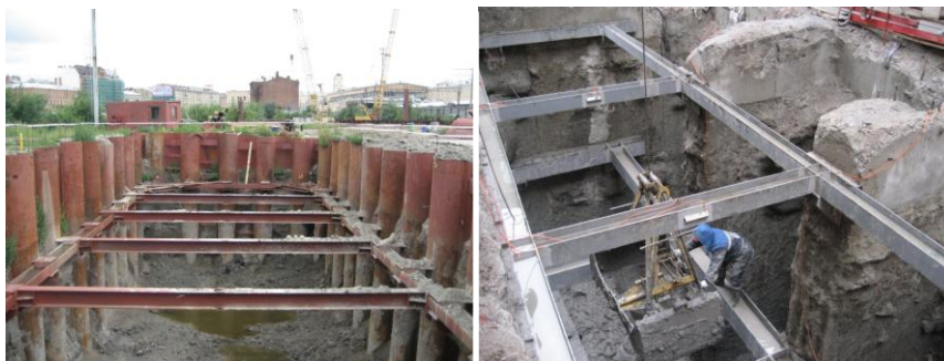
Опытные площадки по устройству глубоких котлованов на территории Санкт-Петербурга с подробным мониторингом поведения грунта
